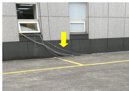
圖 14 建築物拉出室外臨時電線 卻沒固定架高
