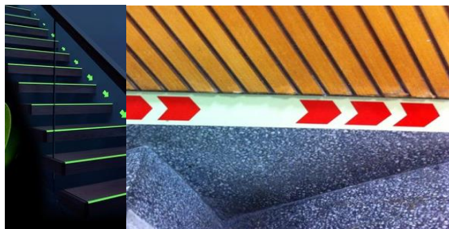
圖 46 樓梯間以螢光箭頭標線明白標示避難方向 (柯一青、林雨君，2021)
