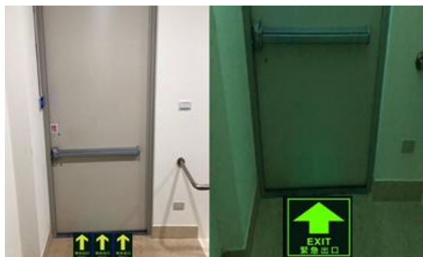
圖 47 出口地面以螢光標示緊急出口 (柯一青、林雨君，2021)
