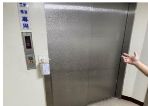
圖 27 工地專用電梯
