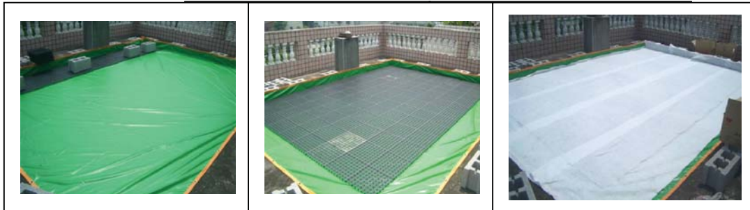
圖 1：平面實驗區鋪設防水布 圖 2：平面實驗區鋪設排水板 圖 3：平面實驗區鋪設不織布
