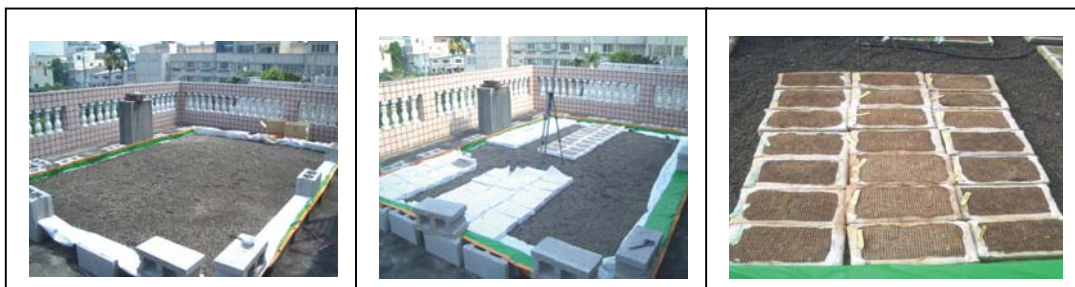
圖 4：鋪設過濾保水資材 圖 5：試驗區置放試驗資材 1 圖 6：試驗區置放試驗資材 2 水陶石及空心磚收邊
